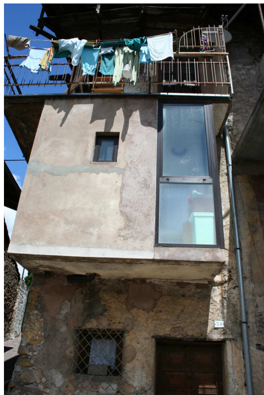
Tamponature non corrette
