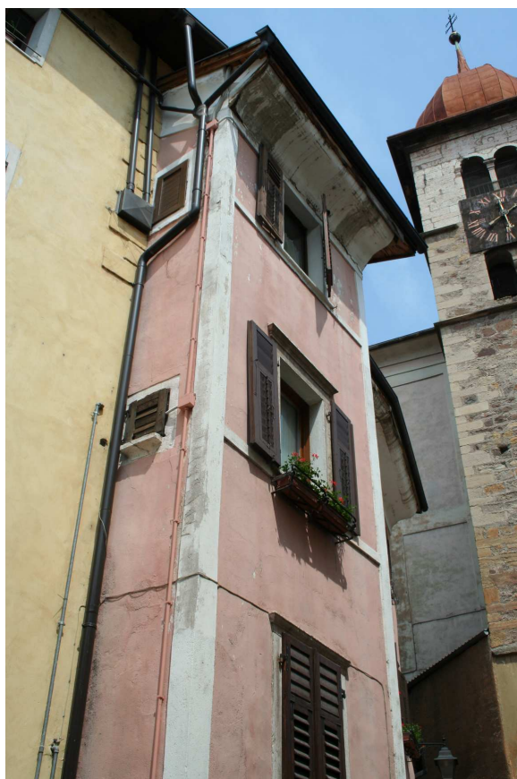
Pluviali non corretti
