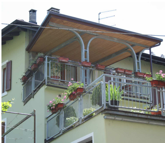
Copertura non allineata - uso di materiali non corretti
