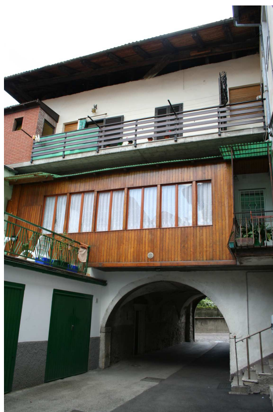
Ballatoi e veranda non corretti
