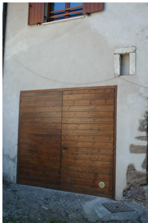
Corretto portale per garage.
