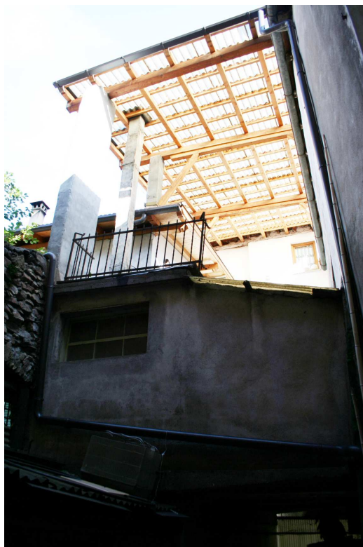
Copertura non corretta in materiale plastico
