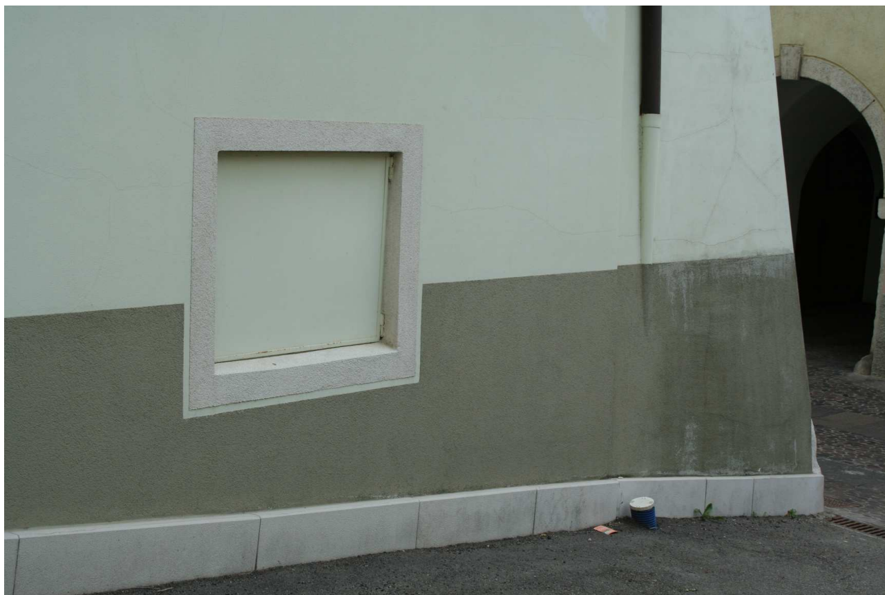
Corretta mascheratura della cassetta di ispezione
