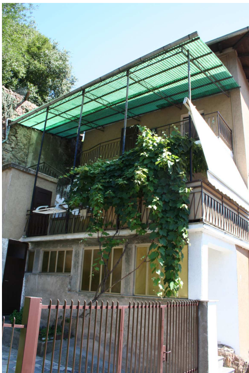
Copertura non corretta in materiale plastico
