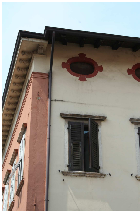
Pluviale e canale di gronda corretto
