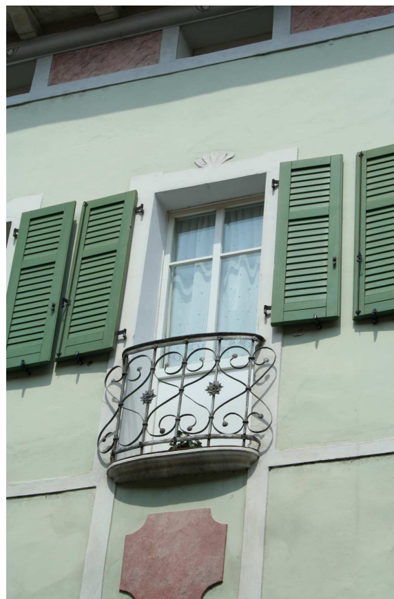
Corretta porta finestra accesso balconcino
