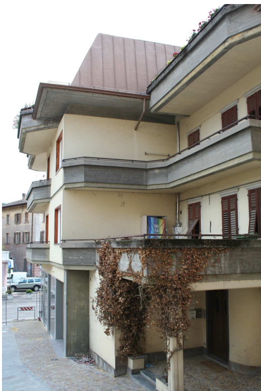
Copertura anomala - non corretta
