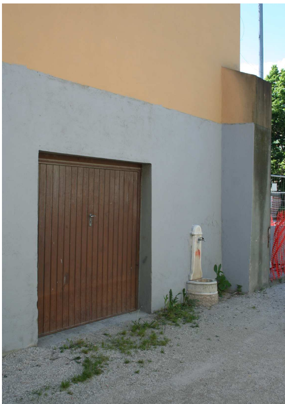
Portone di accesso a garage non corretto
