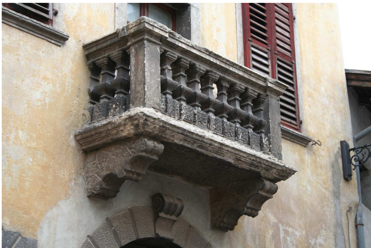
Corretto ballatoio in pietra
