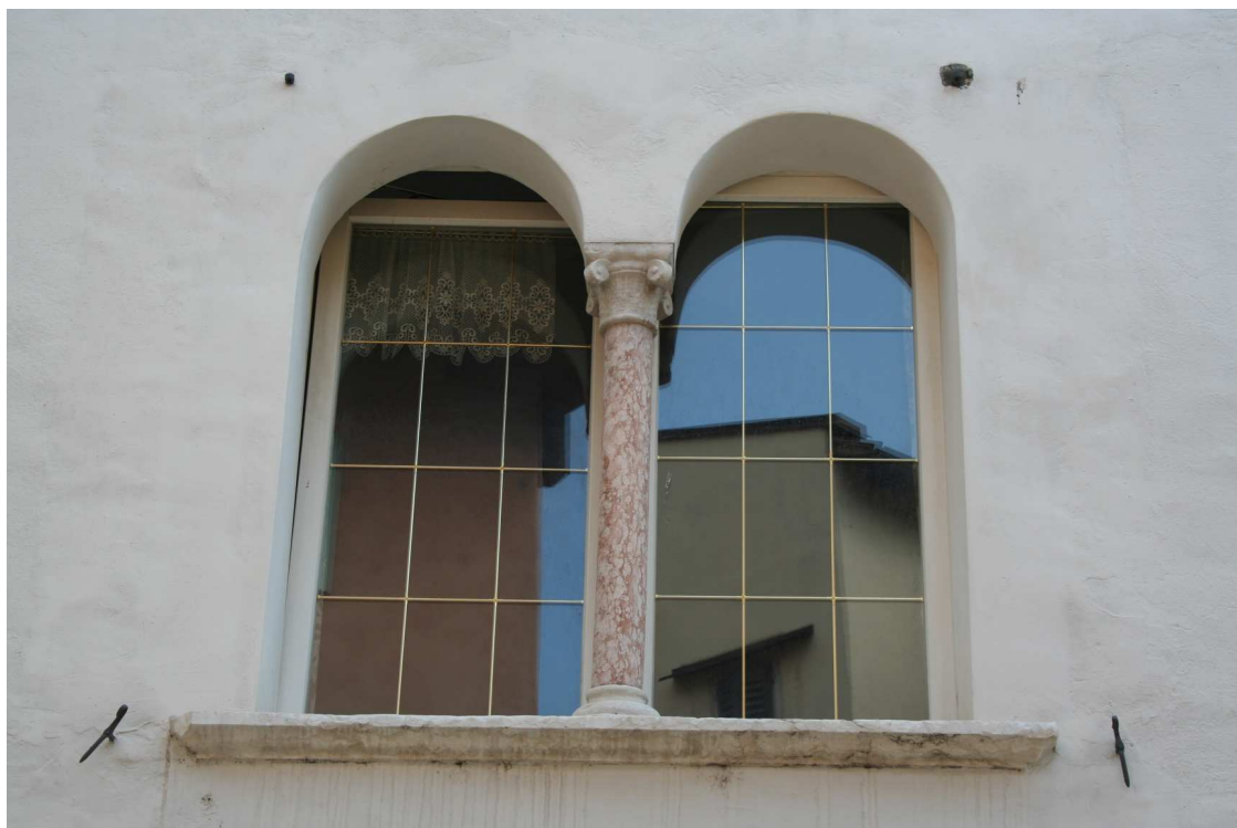
L'infisso non rispecchia la tipologia adatta per un serramento da apporre a una finestra con bifora
