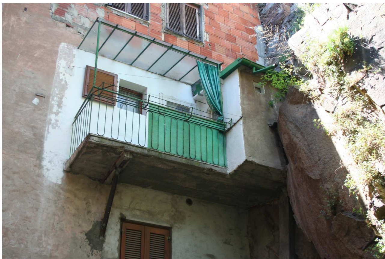
Ballatoio non corretto
