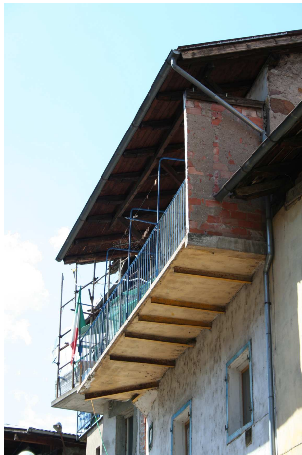
Ballatoio non corretto
